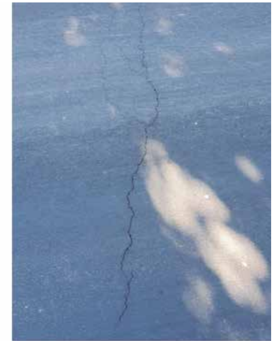
■ Grietas de retracción térmica por envejecimiento prematuro del sello y la exposición a radiación solar
