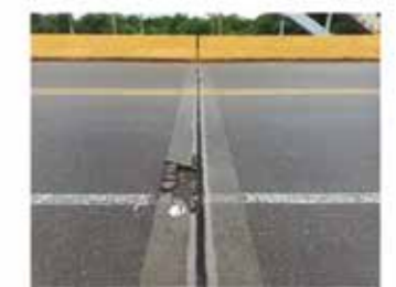
Daño en el bloque de transición por degradación del material
