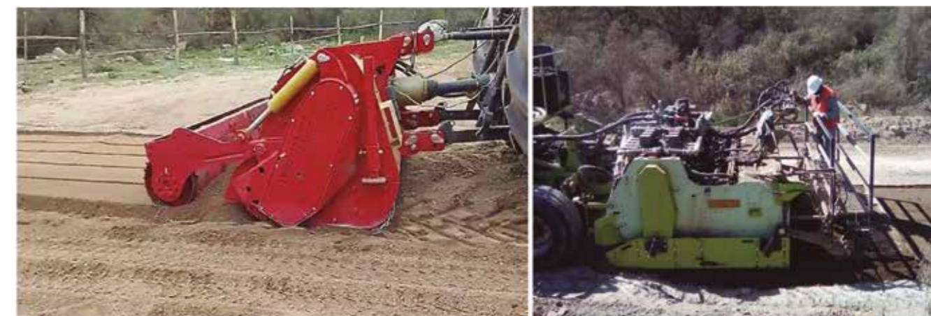
■ Secuencia constructiva con maquinaria recicladora, mezcladora y extendedora especiales. Ruta E-415, construida por empresa particular y Administración Directa Región de Valparaíso, octubre 2021.
