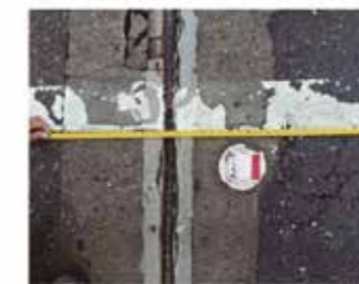
Daño en bloque de concreto y pavimento adyacente
