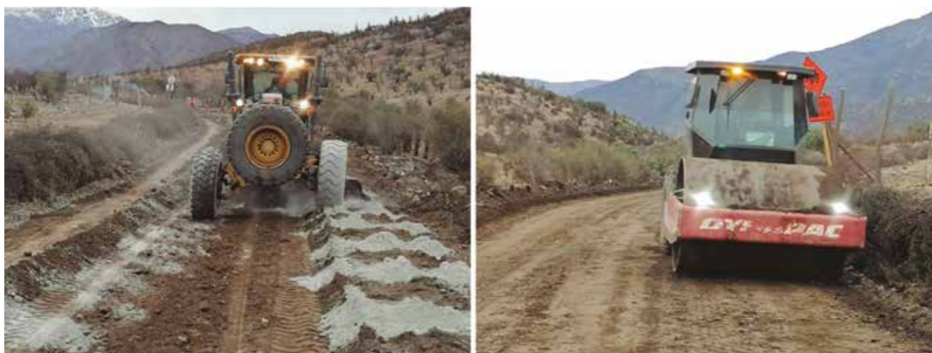
■ Secuencia constructiva tradicional (no se muestra la humectación tras la revoltura). La Vega-Alicahue, construido por Administración Directa Región de Valparaíso, agosto 2022.
